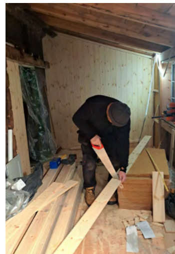
Restaurering av Nesjastova på Hardanger folkemuseum. Alle foto: Anne Lise B. Eriksen, HFU.
